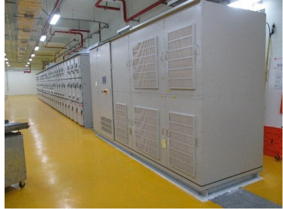
Hình 13. Biến tần FRENIC4600FM6e lắp đặt tại hiện trường cho bơm PM-5207A
