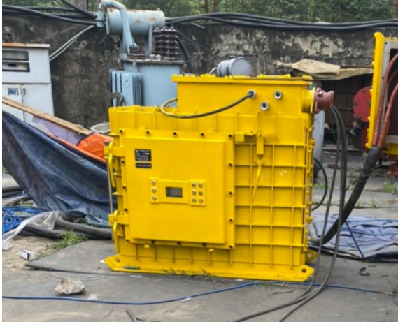
Hình 6: Kiểm tra, thử tải tại mặt bằng kho xưởng Công ty Than Quang Hanh - TKV
