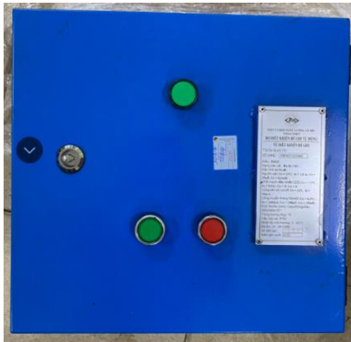
Tủ điều khiển bê ghi
