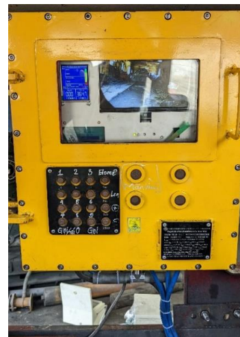
Hình 3: Trạm không dây giám sát tình trạng tàu và điều độ tàu lắp đặt tại hiện trường
