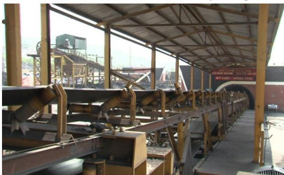
Hình 3. Tuyến băng Bình Minh Công ty than Hòa Gai - TKV
