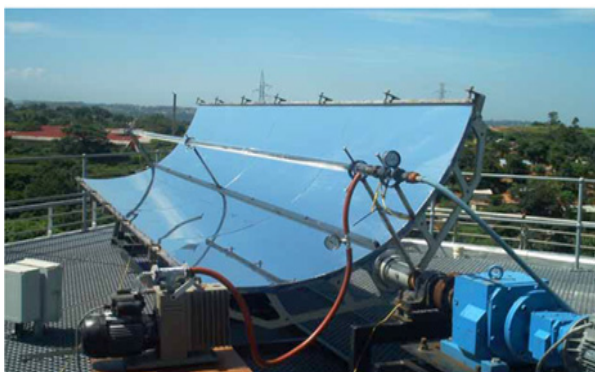
Hình 1 - Hệ thống gương mặt trời
