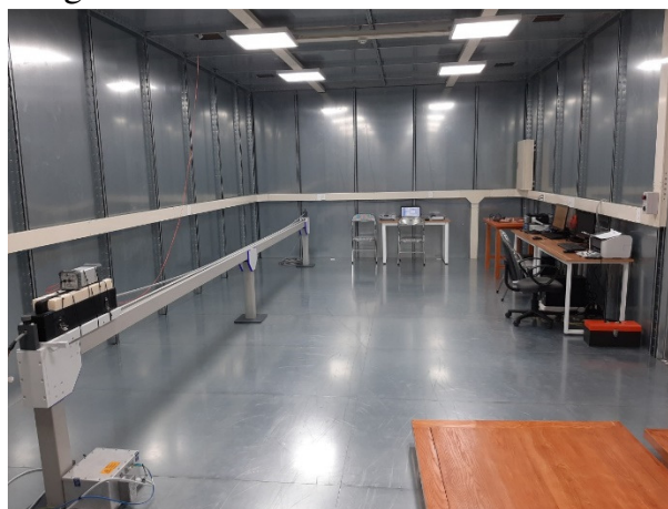
Hình 6: Hình ảnh thực tế phòng che chắn sóng điện từ sau khi hoàn thành lắp đặt
