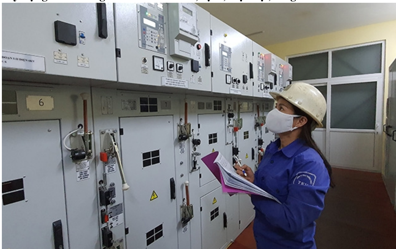
Công tác kiểm tra các thông số tại Trạm quạt gió chính VO-22 khu Lộ Trí, Công ty than Thống Nhất
