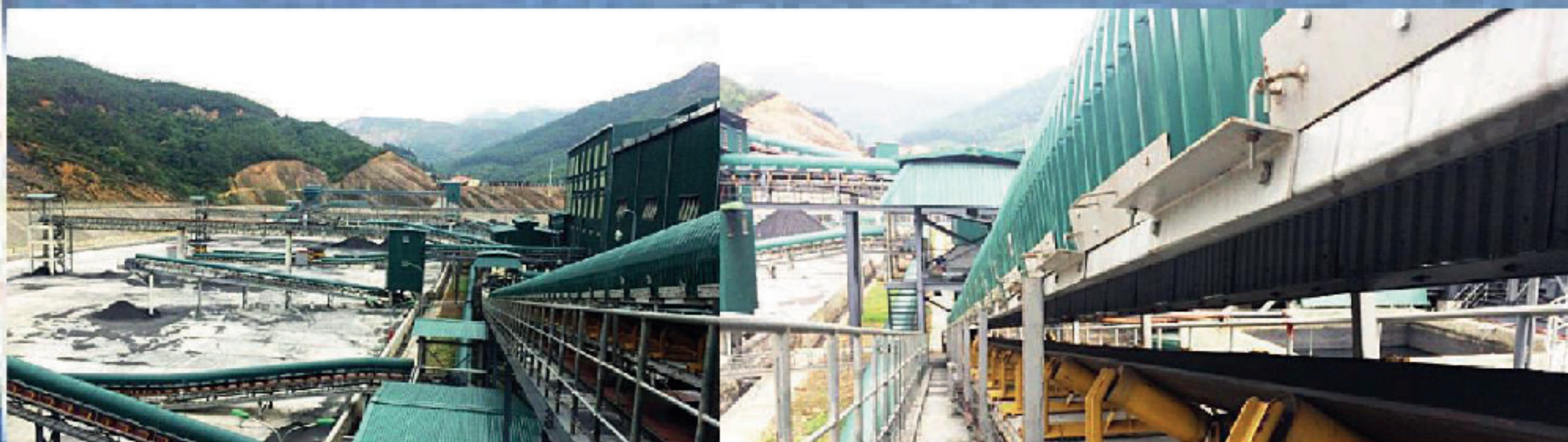
Các tuyến băng tải tại nhà máy tuyển than Vàng Danh 2
