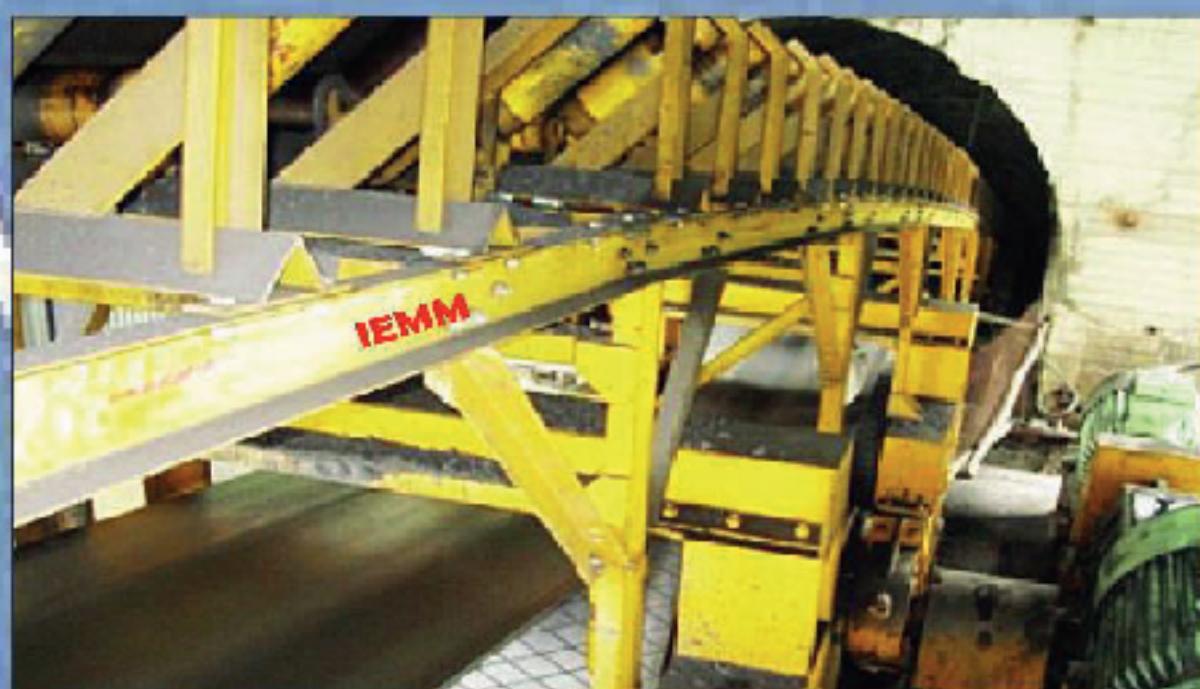
Tuyến băng tải tại Công ty than Dương Huy
