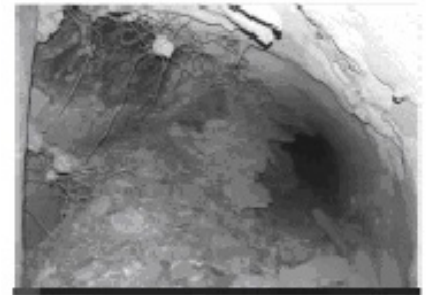
Hình 2: Đất đá vỡ vụn dẫn đến neo cốt thép (cáp) không còn tác dụng chống giữ
