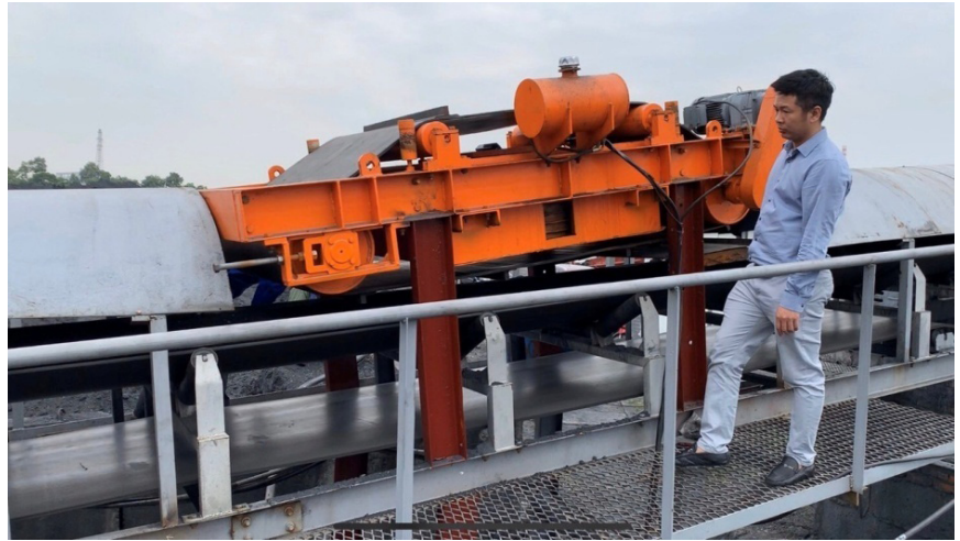
Hình 1: Máy hút sắt nam châm điện - công ty Kho vận Đá Bạc - Vinacomin
