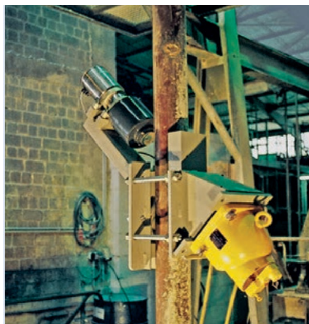
Hình 2.2: Lắp đặt Cảm biến đo tỉ trọng huyền phù ma-nê-tít
