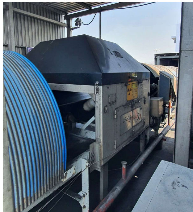
Hình 4. Thiết bị phân tích PGNAA lắp đặt tại Nhà máy Nhiệt điện Vĩnh Tân 2
