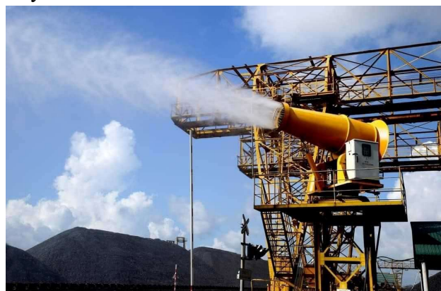
Hệ thống máy phun sương cao áp dập bụi giúp thực hiện công tác bảo vệ môi trường
